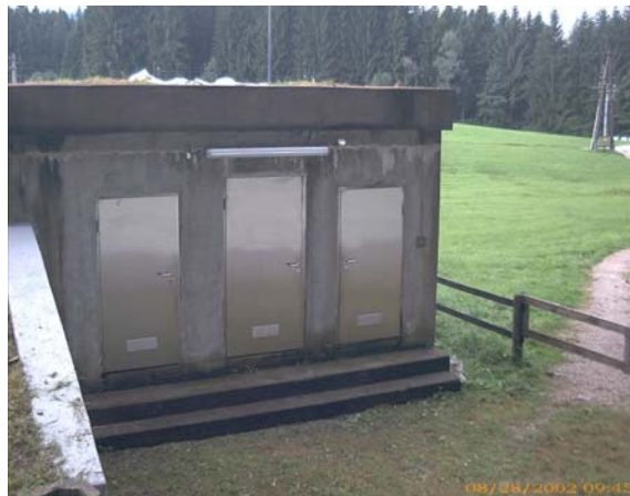
Pumpstation und Eingang Mooshäusl 2
