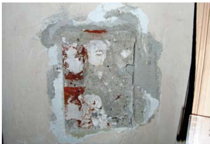
Ein Opferstock wurde gewaltsam mit einem Werkzeug aus der Wand gerissen.
